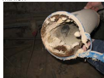
Beskidt nedfaldsrør til færdigvaresilo
